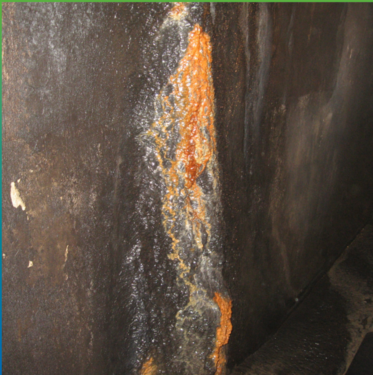
Шов до начала работ
