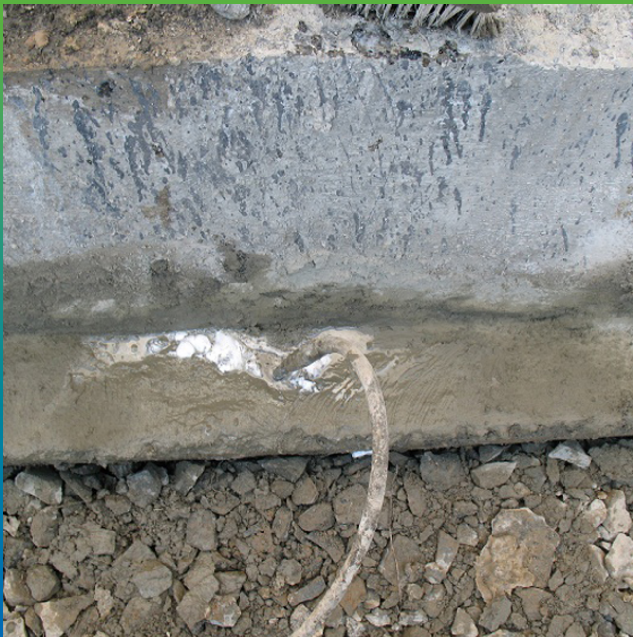
Ликвидация протечек после проведения гидроиспытаний
